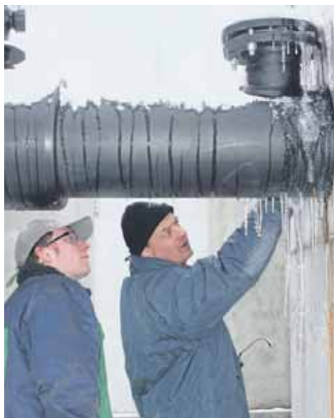
Undicht: Ortwin Faul zeigt Johannes Hopp (l.), wo er Gasaustritt festgestellt hat.
